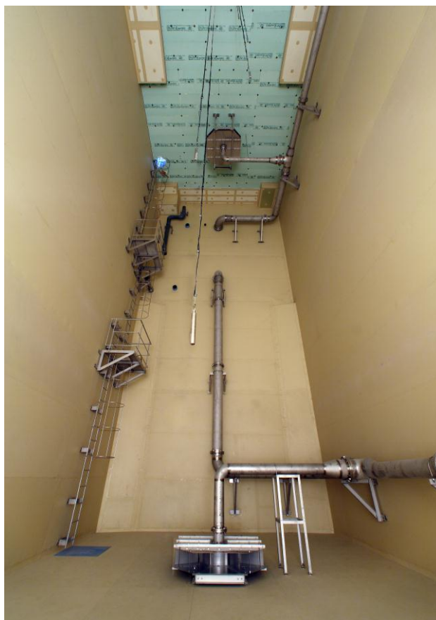
△ 断熱・防水工事が完成した「大容量水蓄熱槽」。この後注水し、現在は満水となっています。
